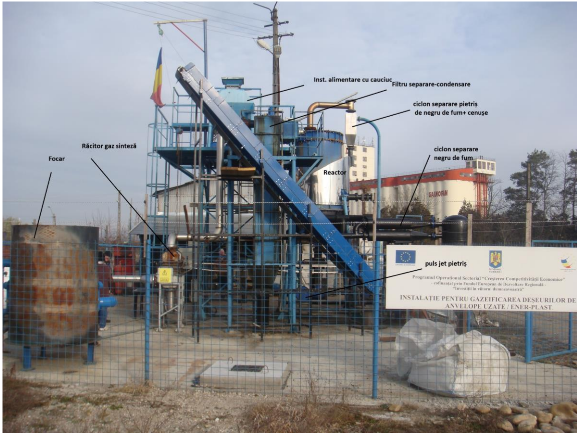
Figura 1. Poze referitoare la Ansamblul instalației
